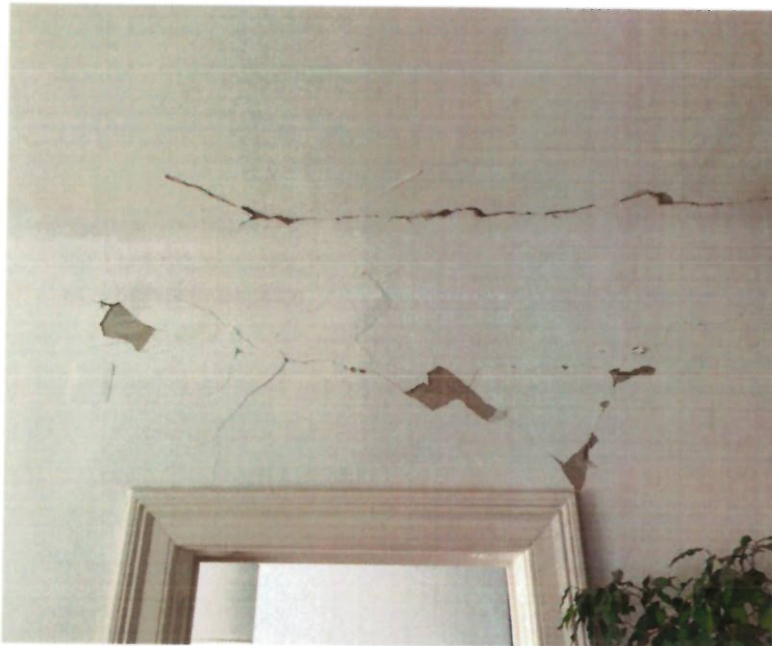
Slika 4-18 Karakteristična oštećenja nadvoja u pregradnim zidovima
