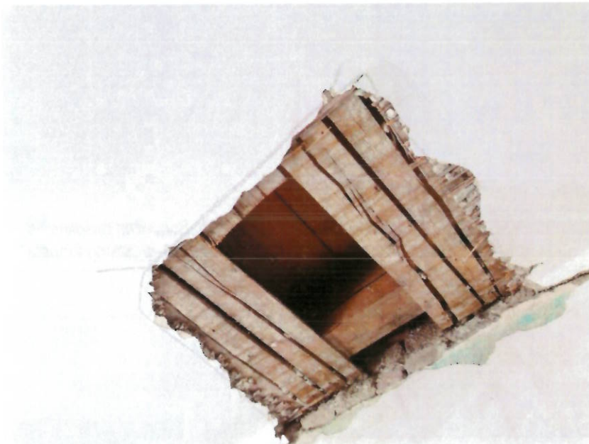
Slika 5-22 Sondažna bušotina 18 – Drveni grednik, zabatni zid
