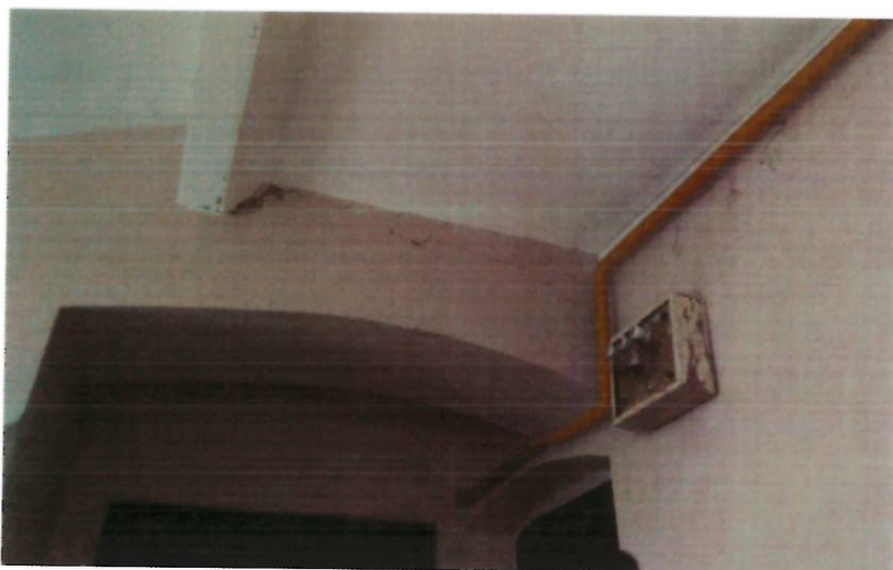
Slika 4-13 Oštećenje nadvoja u zidu stubišta (2. kat)
