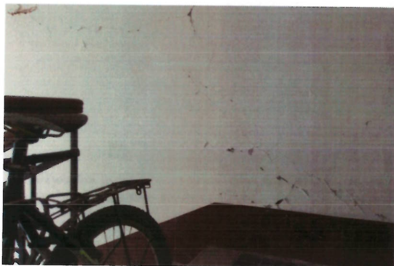
Slika 4-10 Pukotine u stubišnom zidu u potkrovlju
