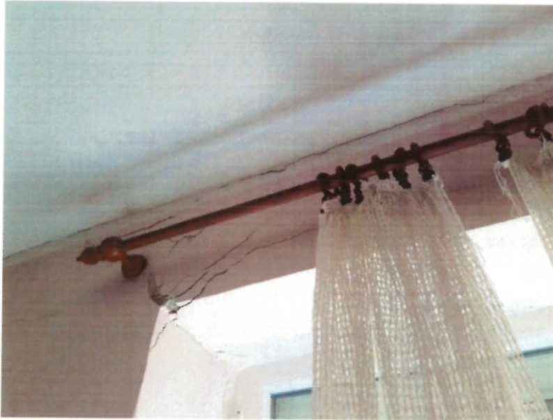
Slika 4-25 Karakteristično oštećenje nadvoja u uzdužnom nosivom zidu
