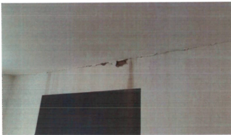
Slika 4-20 Karakteristično odvajanje zabatnog zida i međukatne konstrukcije
