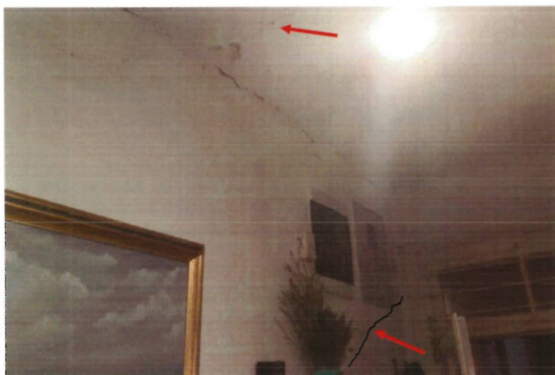
Slika 4-24 Pukotina u uzdužnom nosivom zidu, pukotina na spoju zida i stropa, pukotina uzduž čeličnog profila (1. kat)
