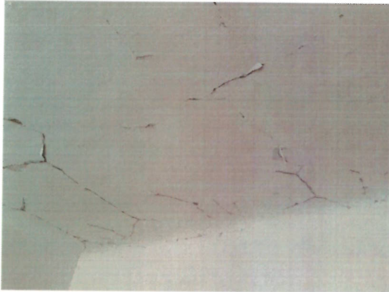
Slika 4-17 Karakteristično oštećenje stropa u stanu (na mjestu drvenog grednika)
