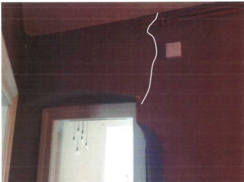
Slika 4-23 Karakteristična pukotina na rubu nadvoja u središnjem uzdužnom nosivom zidu
